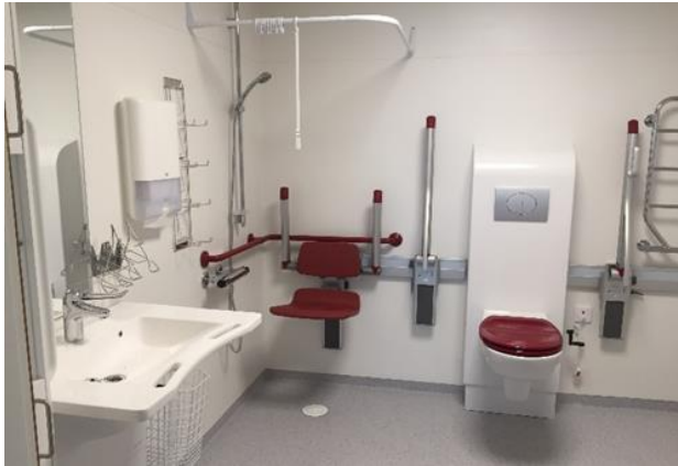
Bild nr 13 Badrum, handfat, dusch och toalett
