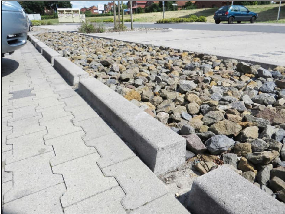
Figur 13. Makadamdike på parkeringsyta. Dagvattnet rinner in i diket via hål i kantstenen (Svenskt Vatten Utveckling, 2019).
